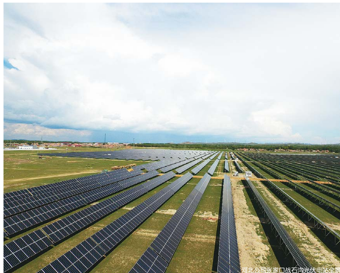
河北公司张家口战石沟光伏电站全景
