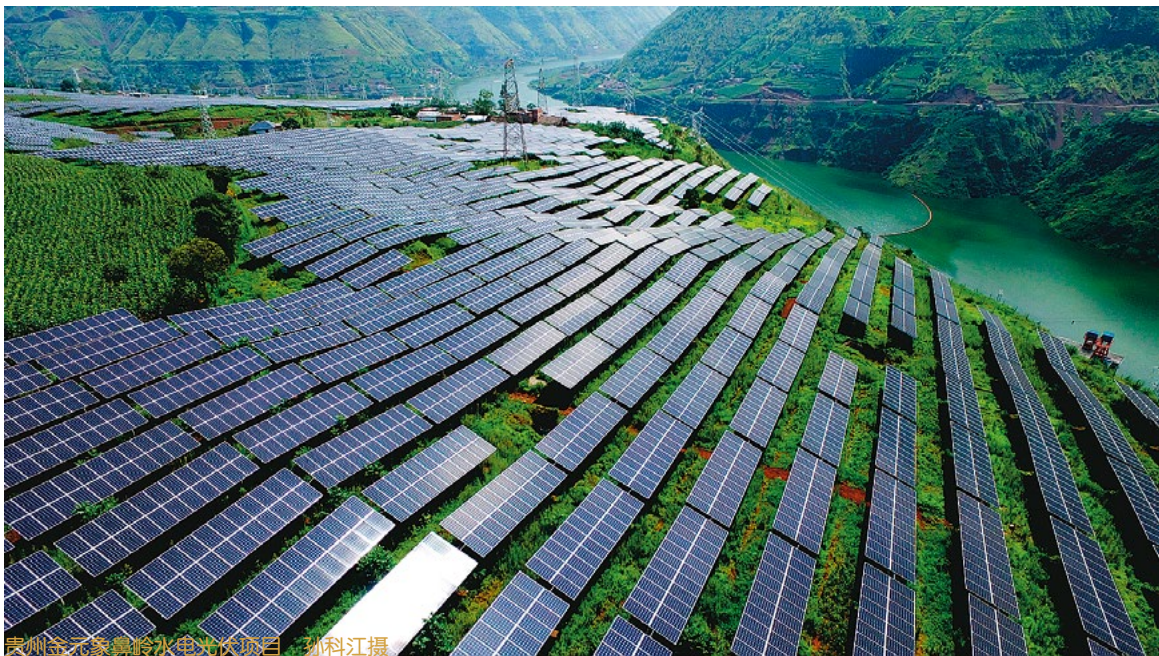
贵州金沙县金沙光伏电站项目 孙科江摄
