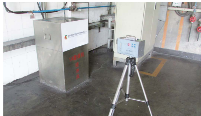
良村热电在现场作业环境进行粉尘监测，保障员工作业环境
