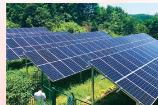
河南省商城县村级电站 ▲
