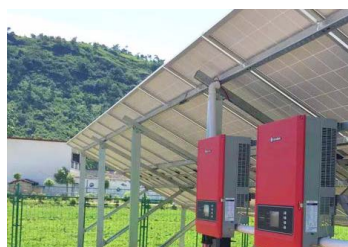
商城县新桥村60千瓦光伏扶贫项目试点
