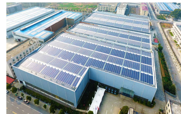
屋顶光伏发电项目
