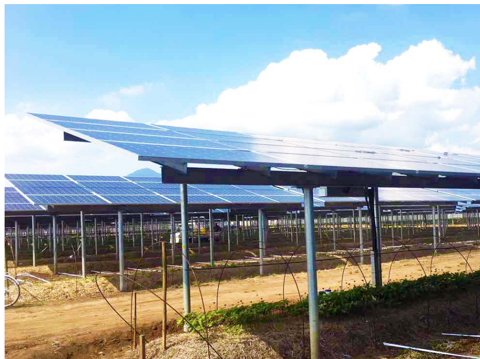
日本茨城筑波光伏项目
