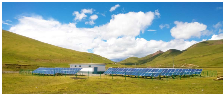
海拔 4117 米的囊谦县着晓乡加恰社 70 千瓦电站
