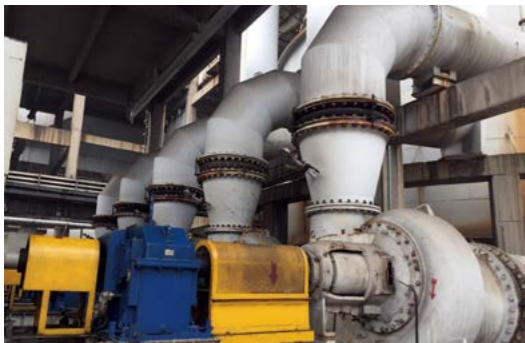
改造机组浆液循环泵
