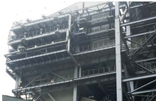
改造机组脱硝装置
