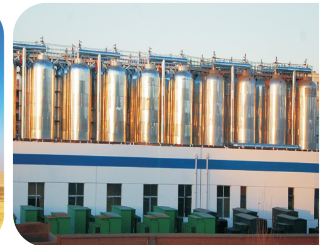
内蒙古四子王旗风电供热站。
