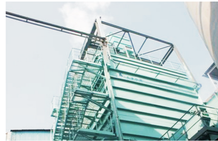
长兴岛第二发电厂湿式除尘器。
