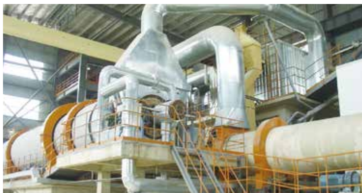
上海外高桥发电厂脱硫石膏煅烧示范线。
