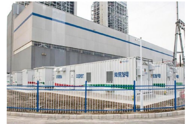
江苏常熟 30W 储能调频电站
