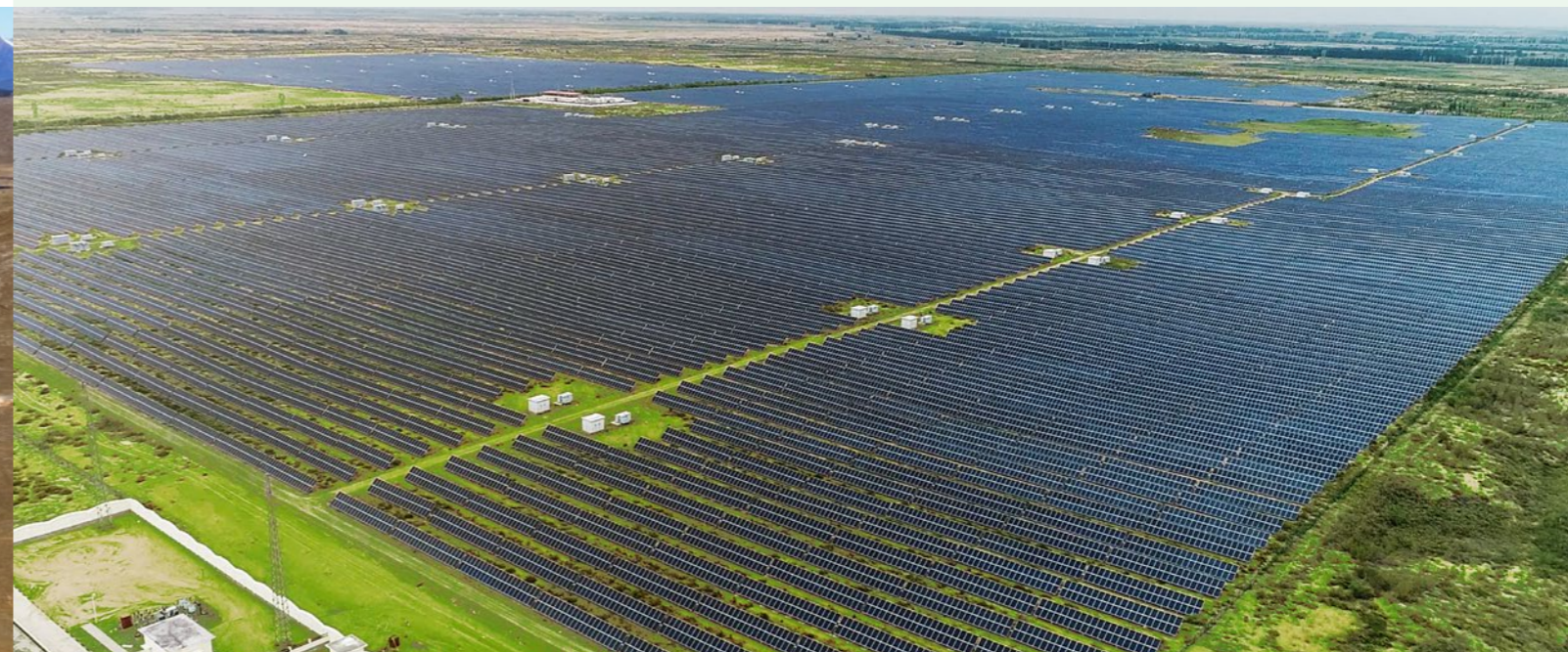
光伏+治沙 ：有效利用沙漠地区充足、无遮挡的光照资源，源源不断地生产零碳清洁能源，还兼有治沙防沙、生态修复的功能，恢复后的土地可以套种各种经济作物，让干旱的沙漠变成绿洲。
