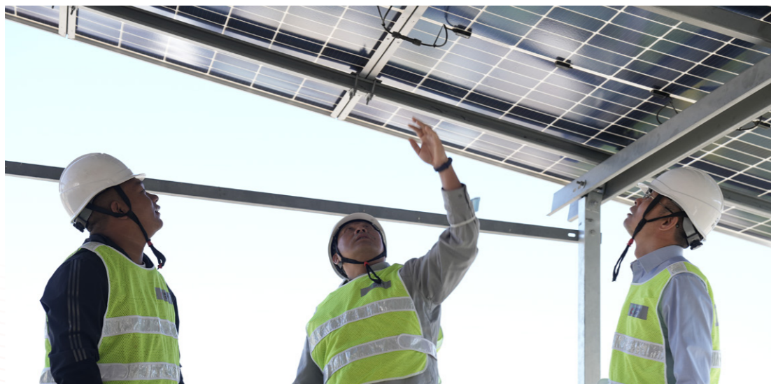
上海能科工作人员正在进行户用光伏巡检工作
