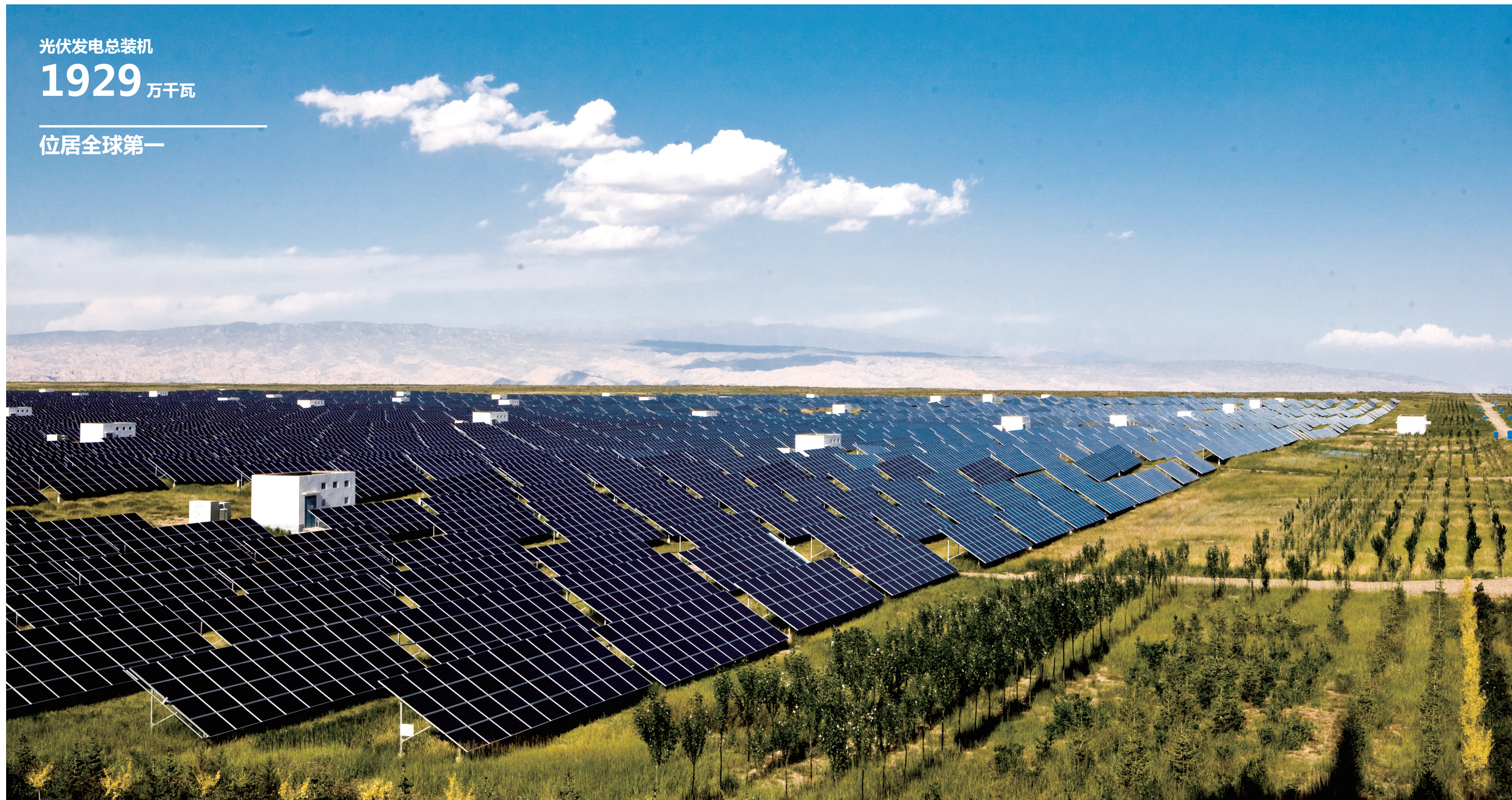
2019 年 6 月 29 日，青海海南州 140 万千瓦多能互补集成优化示范项目建成投产，标志着国家电投清洁能源装机突破 50%。
