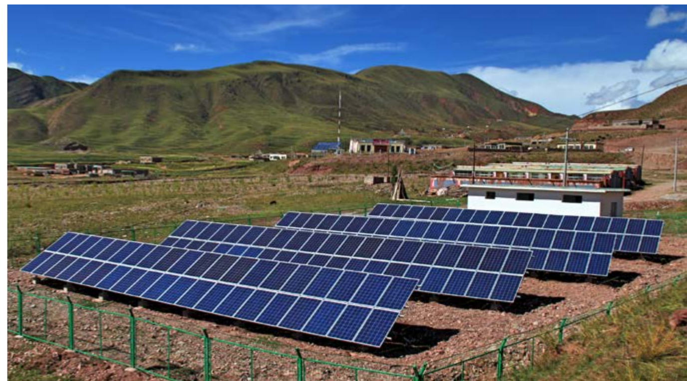
独立光伏电站。
