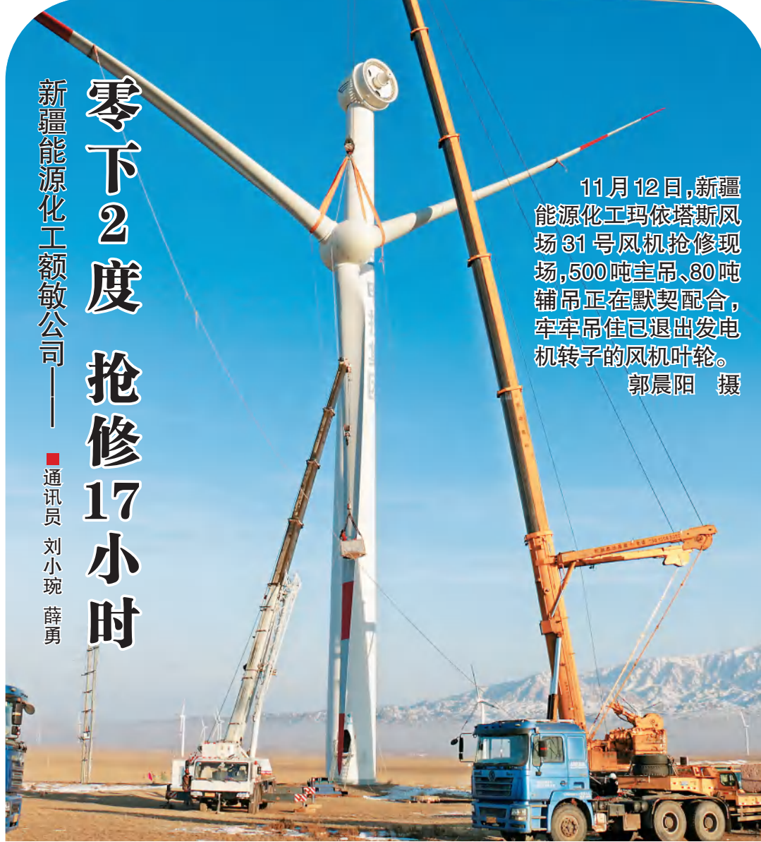
“历时17小时,31号风机1号叶片变桨轴承吊装更换工作已完成!抢修中发现的1号、3号变桨轴承风帽螺栓也全部进行了更换,导正,抢在风速起来之前所有吊装任务实现闭环,此正常用时缩短13个小时。”
